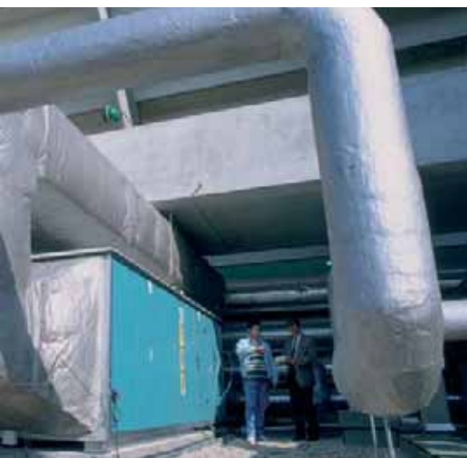
Hệ thống bơm trong các tòa nhà cao tầng
